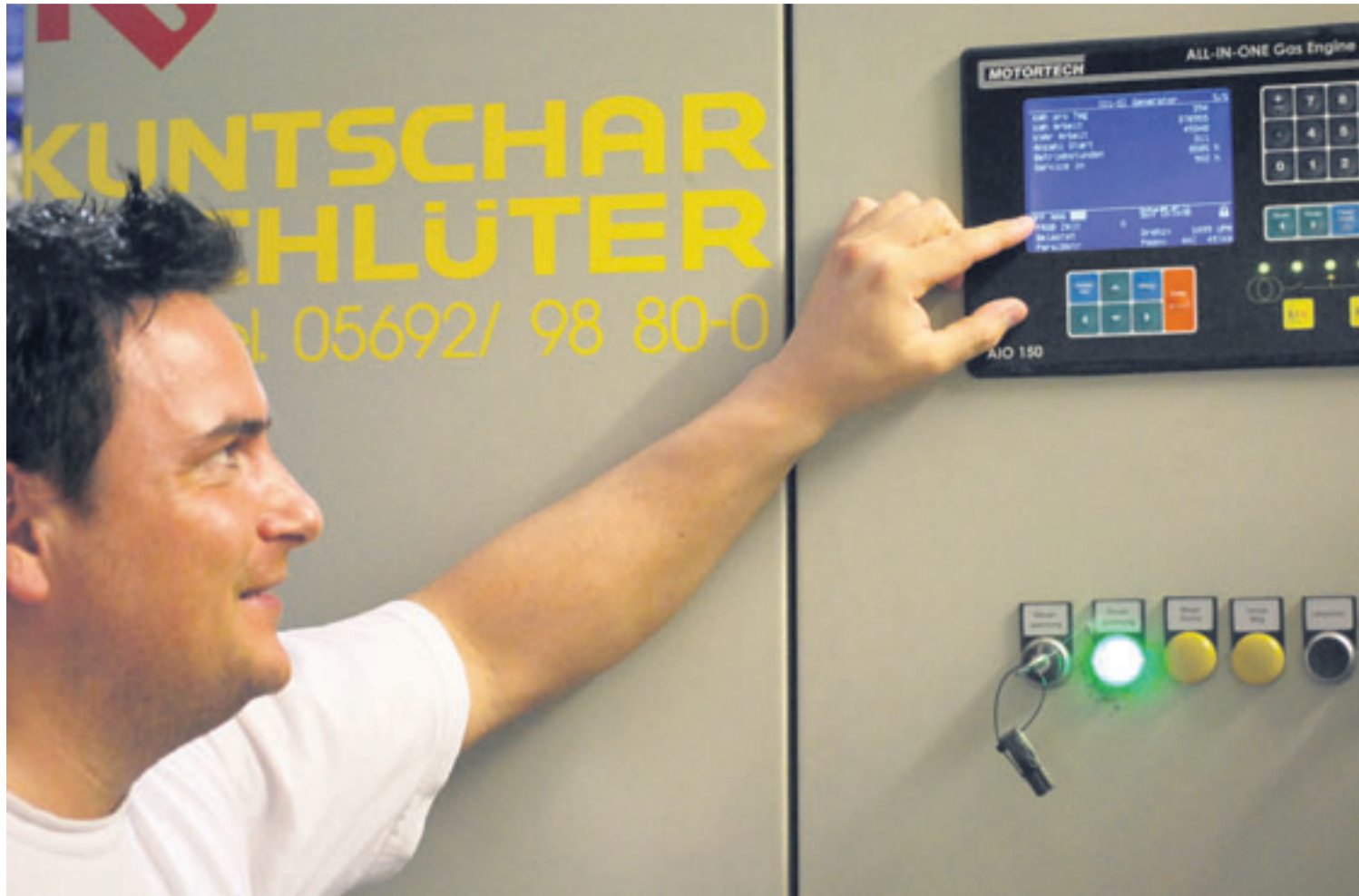
Amin Zeidan, Worpweder Schwimmmeister, ließ sich bei der Kontrolle des neuen Blockheizkraftwerkes über die Schulter schauen. DEK-FOTO: DEK
